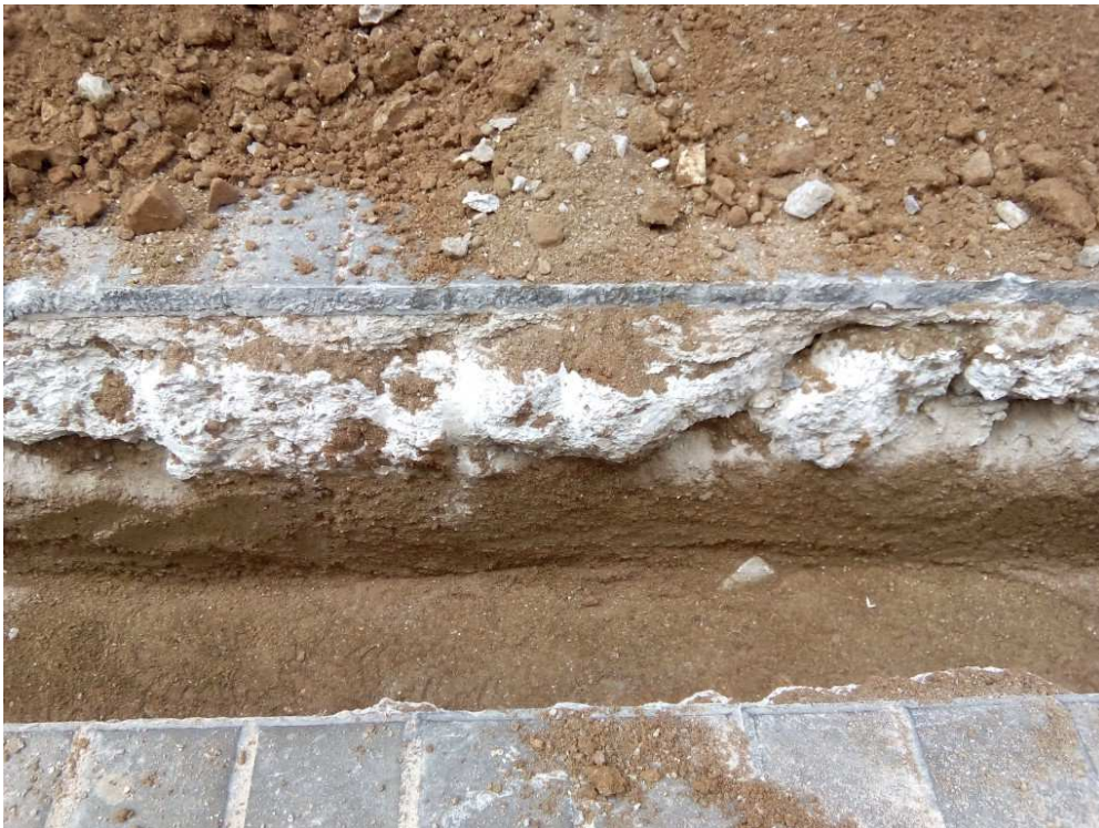
Detall on es pot veure la disposició del paviment actual sobre una regularització de sorres.
